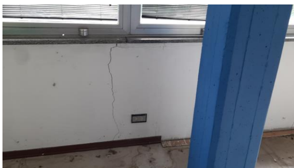
Particolare fessurazione uffici
