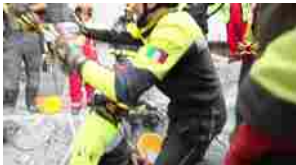
🔍 Crollo a Firenze, terza notte di lavoro per i Vigili del fuoco
